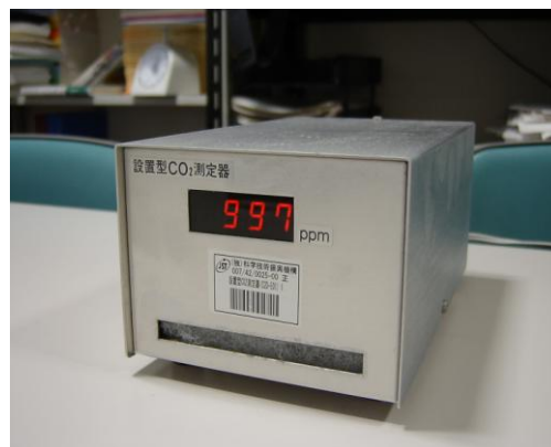
■ CO 2 濃度測定局に設置した機器
